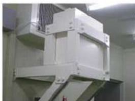
サイクロترون室遮蔽体
