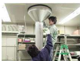
RI施設設備点検(風量測定)
